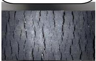
亀裂(クラック)
